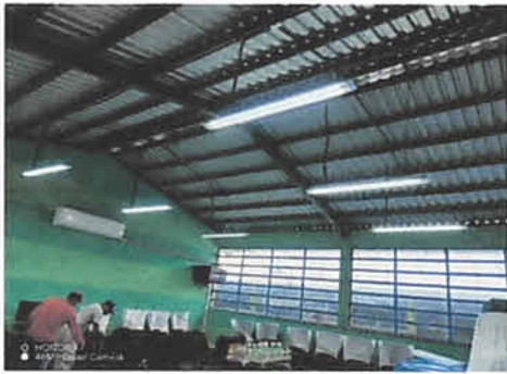
Foto 3: culminación de instalación de alumbrado eléctrico en aulas con lámparas tipo listón.
